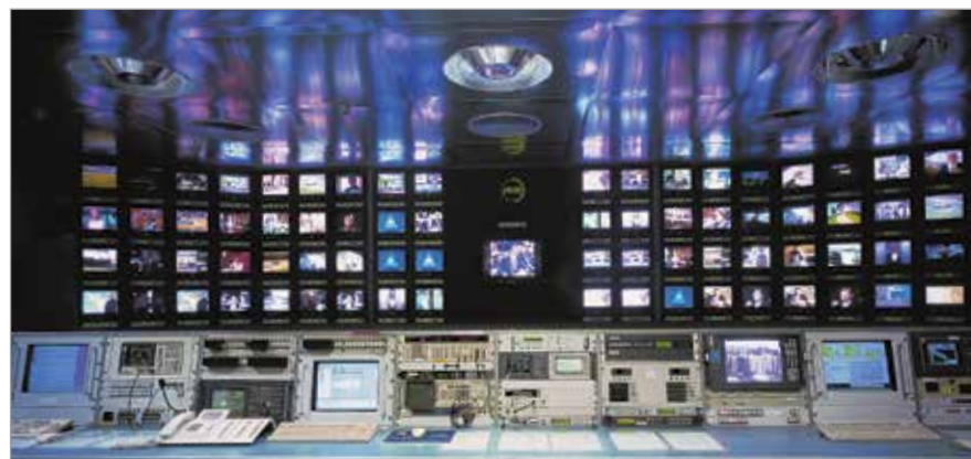
Die Bodenstation Betzdorf ist das Herz des ASTRA- und SES-Verkehrs.
